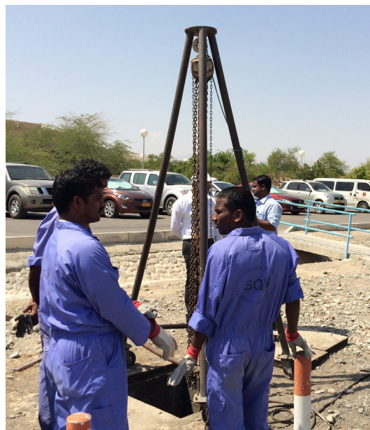
Operarios de una estación de bombeo situada en una de las residencias de estudiantes de la universidad Sultán Qaboos instalando Flygt Concertor.
