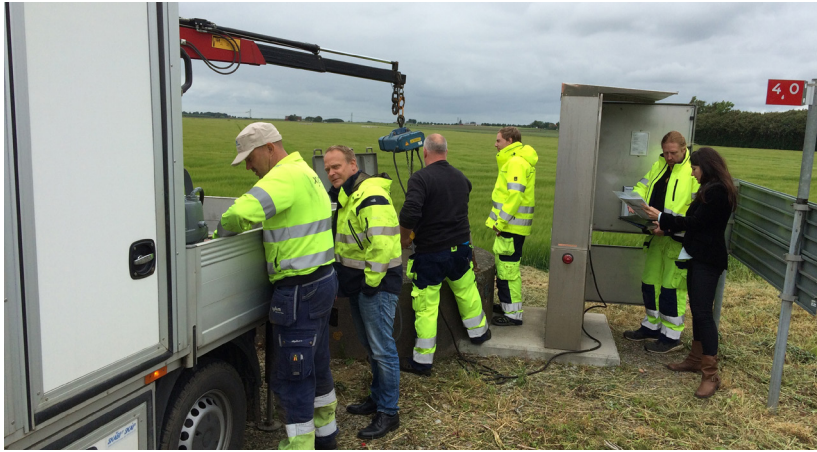
Instalación de Flygt Concertor en la ciudad de Lomma.
