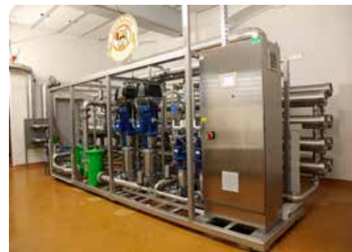
Umkehrosmose-Anlage mit frequenzgeregelten, mehrstufigen Lowara-Pumpen der Baureihe SV sorgt für gleichbleibende Brauch- und Brauwasserqualität.
